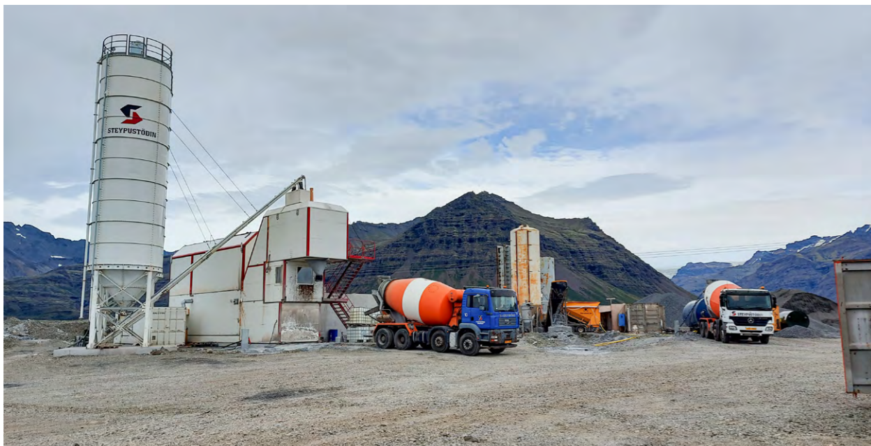
↑ Færanleg steypustöð sem ÍSTAK setti upp við brúna á Steinavötnum í Suðursveit. Þar var framleidd steypa fyrir brýr á Steinavötnum, Fellsá, Kvía og Brunná.
